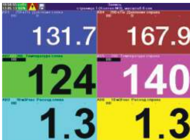
3. Цифровое отображение. Отображаются: текущее значение сигнала для каждого канала, имя канала, единица измерения, тип и период выборки.
